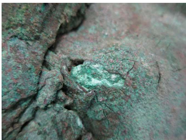
Figura 26. Detalle de un de los focos de cloruros de cobre activos. ©M. Turégano 2016
